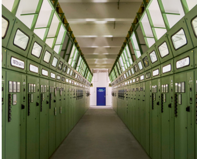
70er-Jahre-Chic: Blick in ein Umspannwerk, das bald von modernster Technologie abgelöst wird.
